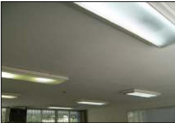
Figura 4. Instalaciones eléctricas en el ITA. Lámparas encendidas innecesariamente.
