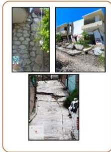
Figura 1: Daños en viviendas e infraestructura en colonias del norponiente de Chilpancingo.
